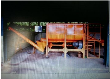
固肥的發酵設備
