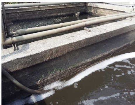
旁邊牆壁，宛如洗過一樣
