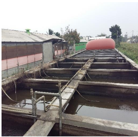
污水處理廠全景(可容納 4000 噸)
